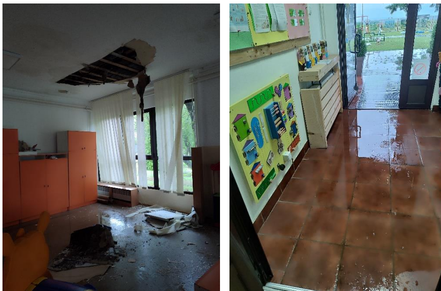
Слика 1. 2. Оштећење објекта
