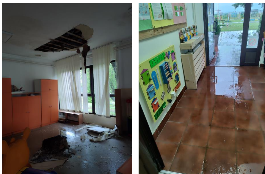
Слика 1. 2. Оштећење објекта
